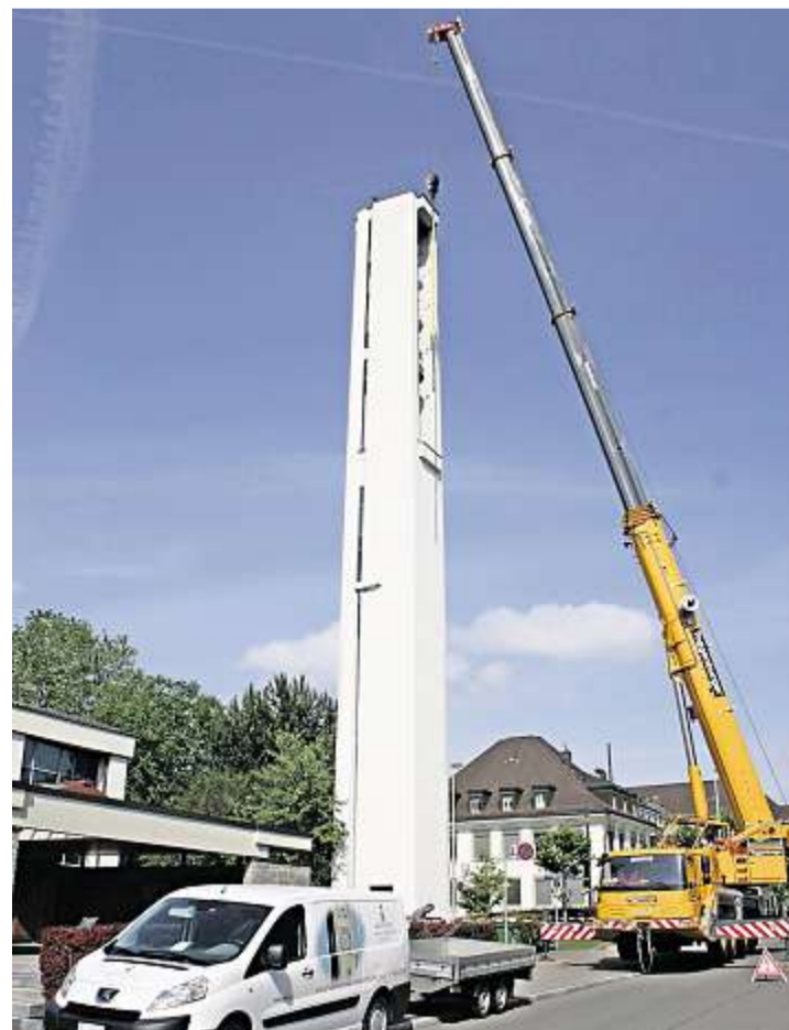
Ein tonnenschwerer Kran hievte die Glocken aus ihrem angestammten Platz im Kirchturm.
